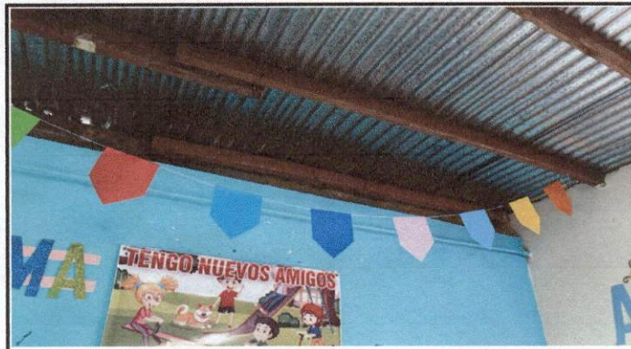
Foto 2: SITUACIÓN ACTUAL DE LÁMINA Y ESTRUCTURA EN AULA 4
