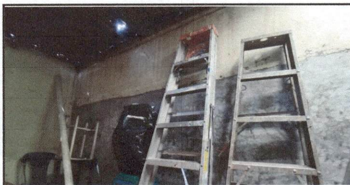
Foto 5: ESTADO ACTUAL DEL TECHO EN ÁREA DE BODEGA
