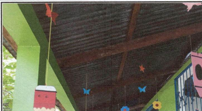
Foto 1: SITUACIÓN ACTUAL DE LÁMINA Y ESTRUCTURA EN CORREDOR DE LA ESCUELA
