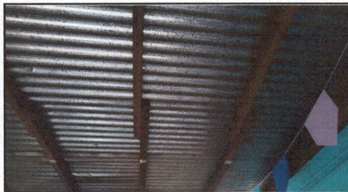
Foto 4: IMPROVIZACIÓN DE TECHO EN AULA 4
